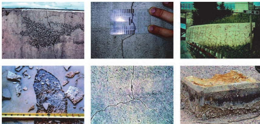
Slika 2. Uobičajena oštećenja armiranog betona na nuklearnim postrojenjima [28]
